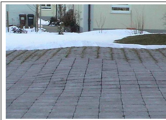
Abb. 4 Frosthebungen bei eingefrorenen Sondenanschlussleitungen
